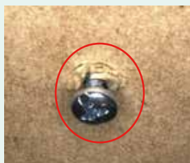
ネジが緩んでいる画像
